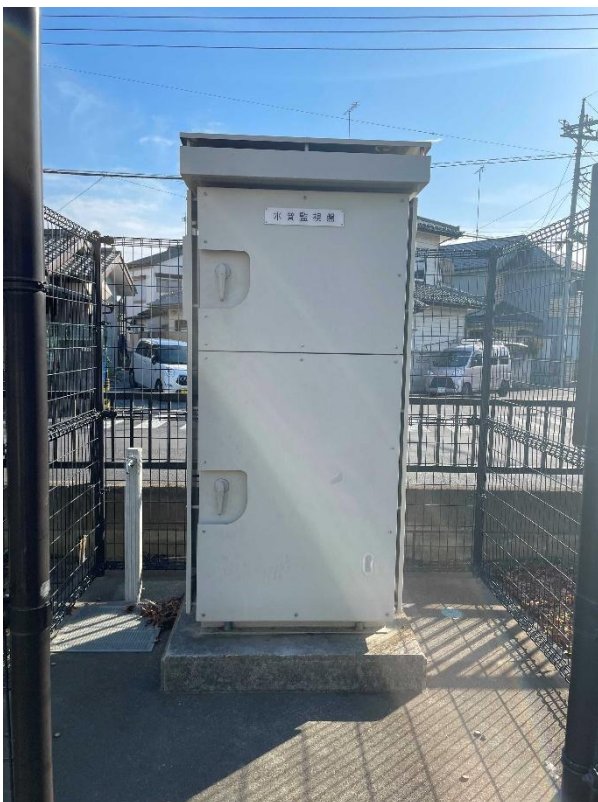
新宿第一公園水質監視盤
