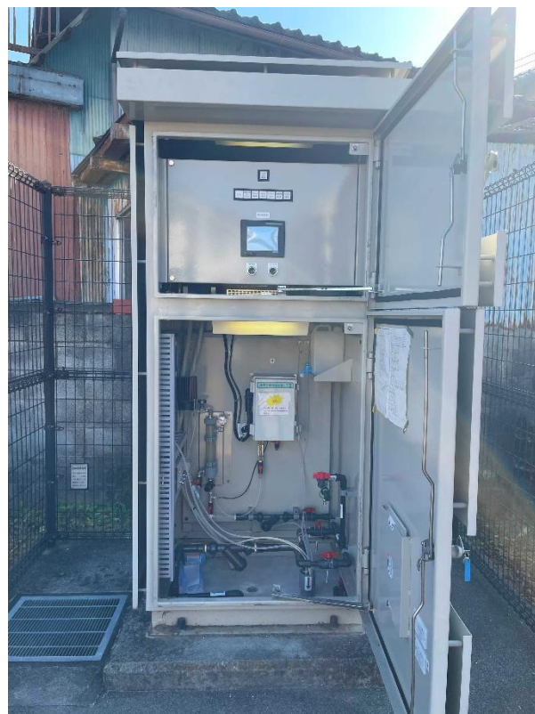
境第三公園水質監視盤
