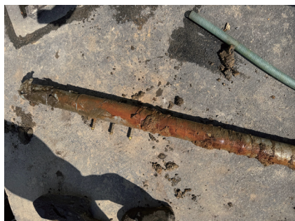
老朽化した配管
