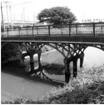
補強が望まれる前屋敷橋
