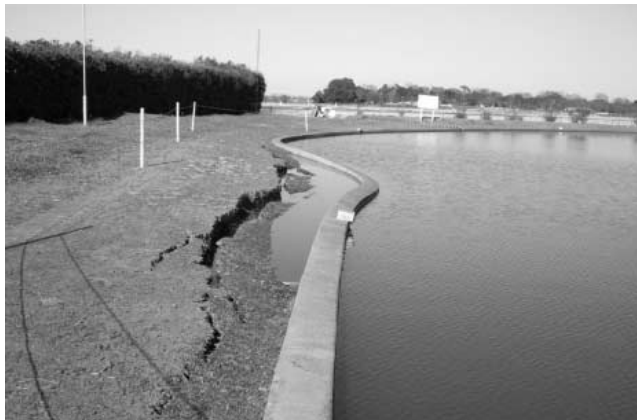
修繕が待たれる弁天池
