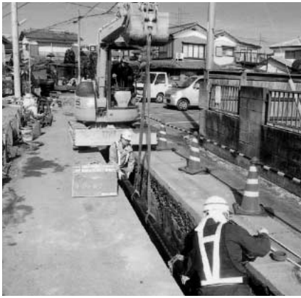
石綿管の早急な布設替えを
