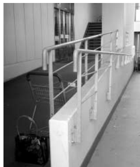
改善が必要と認めた手すり
