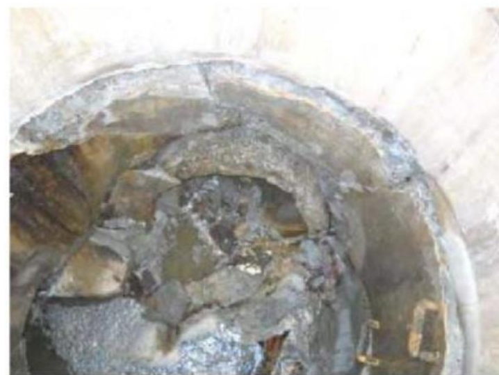
マンホールと管きよの接合部破損
