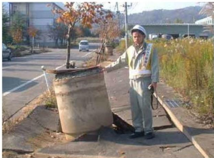
液状化によるマンホール突出
