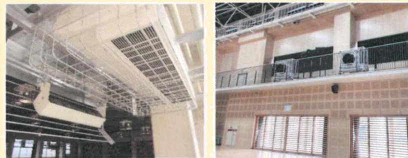
災害時にも利用可能な学校体育館の空調設備
