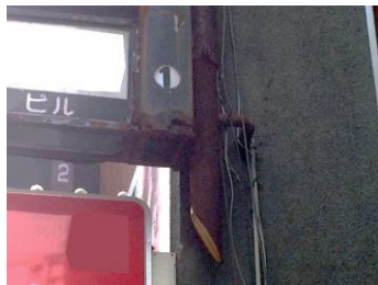
支持部が腐食した状態
