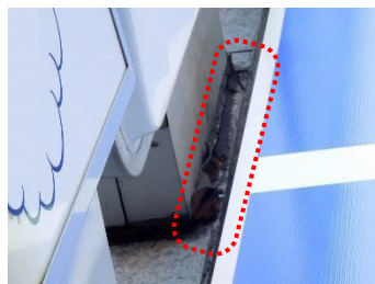
コーキングが劣化した状態
