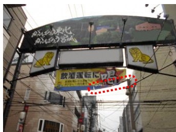
幕材を張る部材が破損した状態
