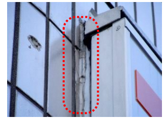
コーキングが劣化した状態
