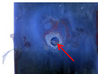
水抜き孔の詰まり
