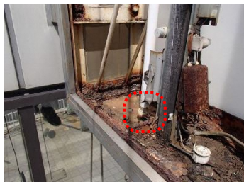
蛍光灯のホルダーが破損した状態
