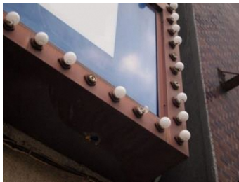
ランプ球が破損した状態
