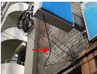
振れ止め棒が変形した状態
