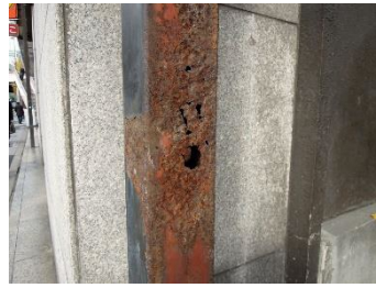
支柱の腐食が進行した状態
