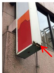
広告板底部の腐食が進行した状態
