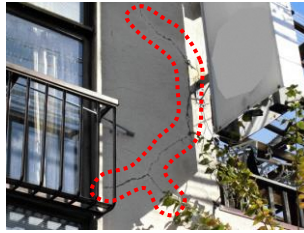
壁面にひびが生じた状態
