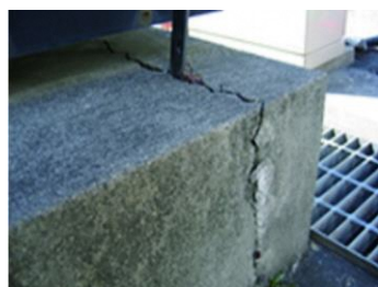
基礎にクラックが入った状態
