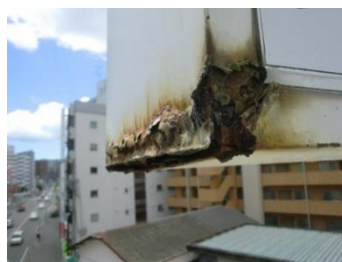
側板の腐食が進行した状態
