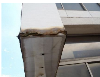
側板の腐食が進行した状態
