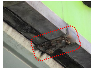
金具が劣化した状態
