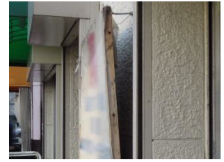
壁面との間に隙間が生じた状態
