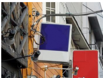
屋外広告物本体の傾き
