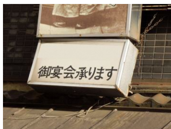
屋外広告物本体の傾き
