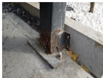
支柱根元の腐食が進行した状態
