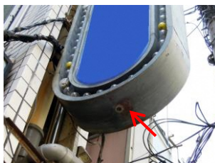
水抜き孔が詰まった状態
