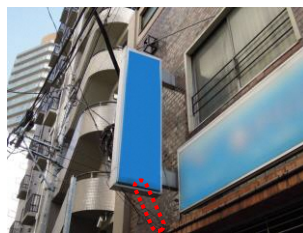
振れ止め棒が変形した状態
