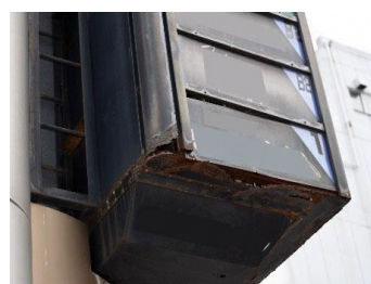
側板底面が腐食、破損した状態
