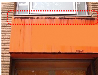
その他（塗装剥離、腐食など）
