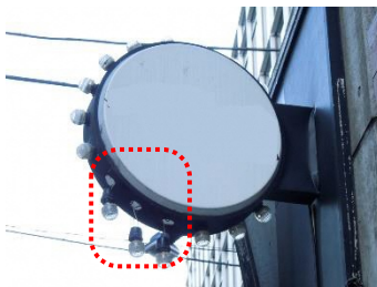
照明器具の傾き、外れ
