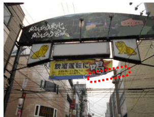
幕材を張る部材が破損した 状態
