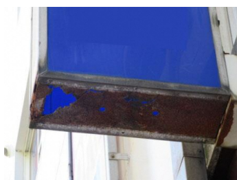
側板底面が腐食、破損した状態
