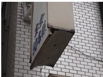
その他 （塗装剥離、腐食など）
