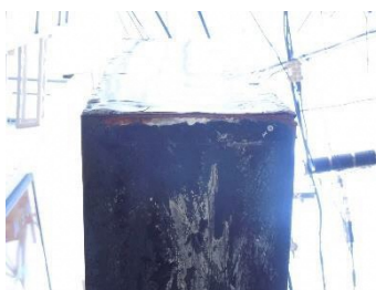
側板底面にさびが発生した状態
