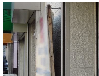
壁面との間に隙間が生じた状態
