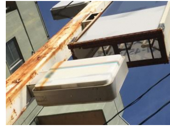
支柱にさびが発生した状態
