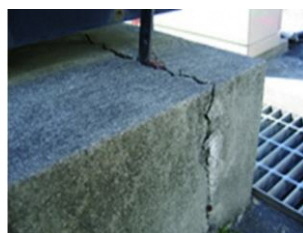
基礎にクラックが入った状態
