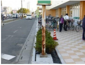
支柱の腐食が進行した状態
