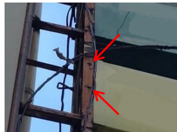
ボルトのゆるみや欠落した状態
