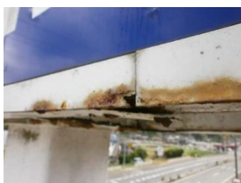
その他（塗装剥離、腐食など）
