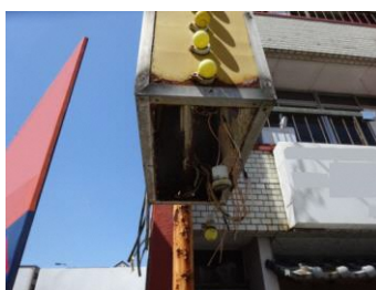
側板底面が欠損した状態
