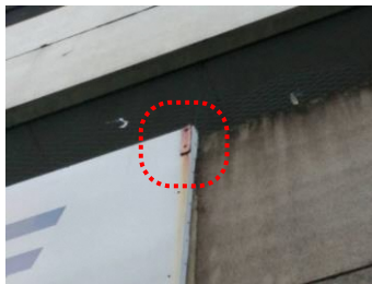
金具が劣化した状態
