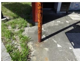
支柱の腐食が進行した状態
