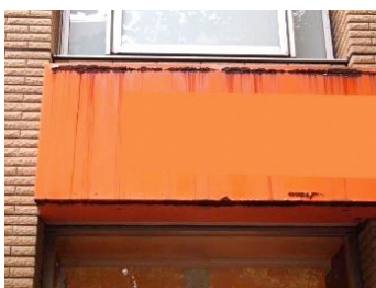
側板の腐食が進行した状態
