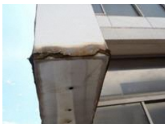
広告板底部の腐食
