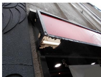
側板底面の腐食が進行した状態
