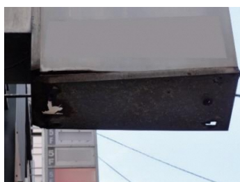
側板底面が腐食、破損、変形した状態
