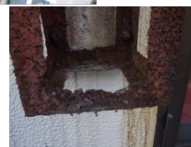
支持部が腐食していた看板の例
