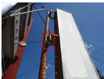
支柱・広告板接合部の腐食・隙間
