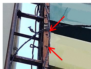
ボルトのゆるみや欠落した状態
