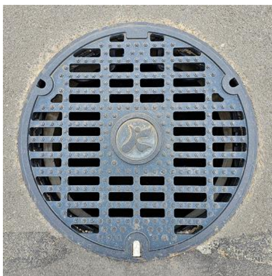
図 8 雨水のマンホール
