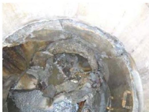
マンホールと管きよの接合部破損 (下水道地震・津波対策技術検討委員会報告書)
