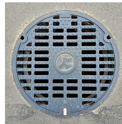
図 8 雨水のマンホール
