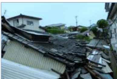
・・「倒壊した民家」・・
