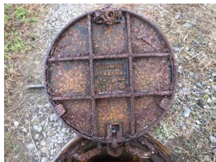
管路施設（マンホール蓋の劣化・郷地安養寺地区）
