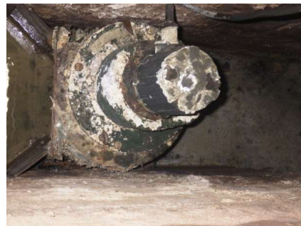
処理施設（機械設備の劣化・上会下地区）
