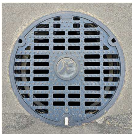
図 8 雨水のマンホール
