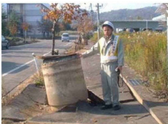
液状化によるマンホール突出 (下水道地震対策技術検討委員会報告書)
