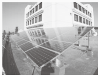
■ 市役所本庁舎の太陽光パネル
