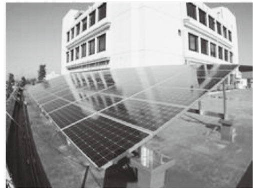
■市役所本庁舎の太陽光パネル
