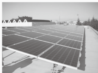
■ 屋根貸し事業で設置した太陽光パネル（箕田公民館）
