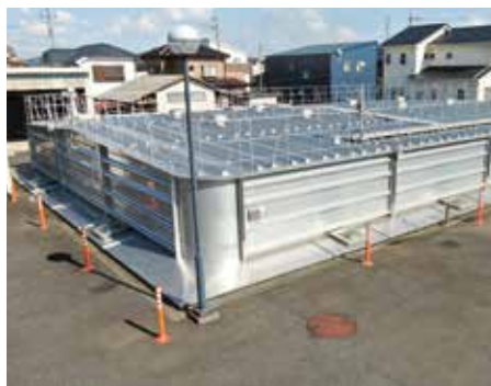
強度の高いステンレス製の配水池 (人形浄水場)
