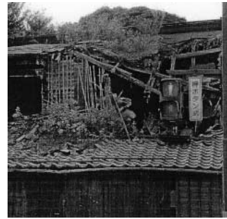
朽ちた家屋は防火・防災・景観からも問題です
