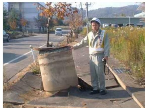
下水道マンホールの液状化
