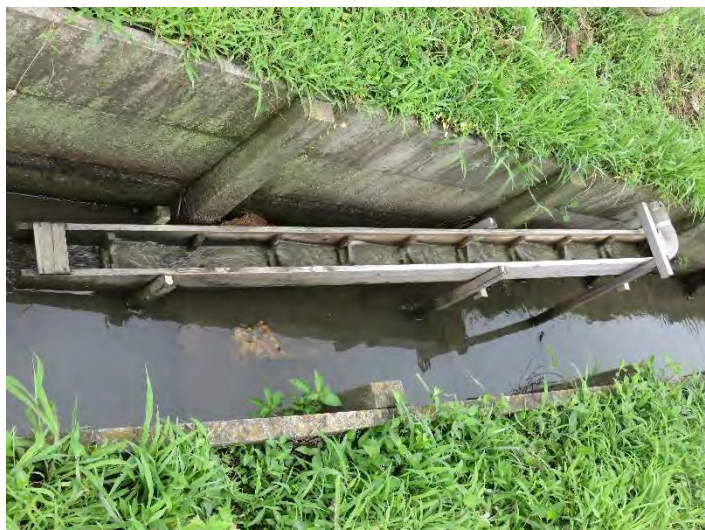
水田と用水路をつなぐ魚道
