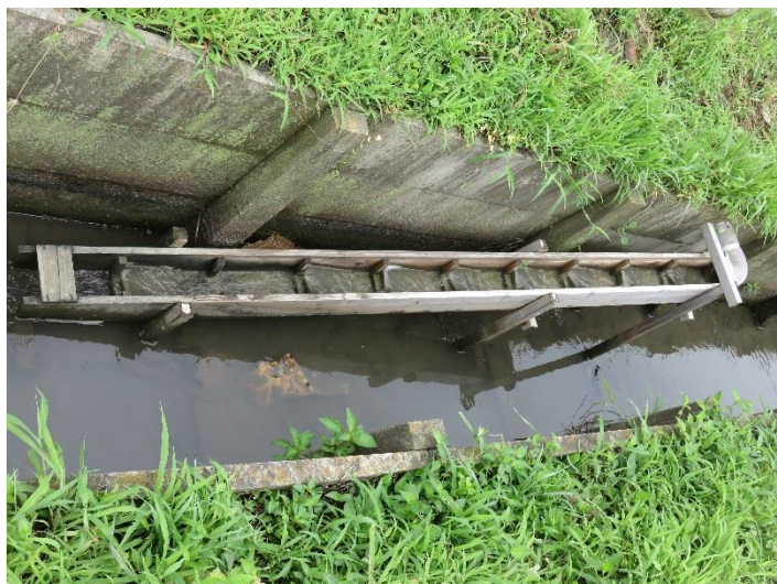
水田と用水路をつなぐ魚道
