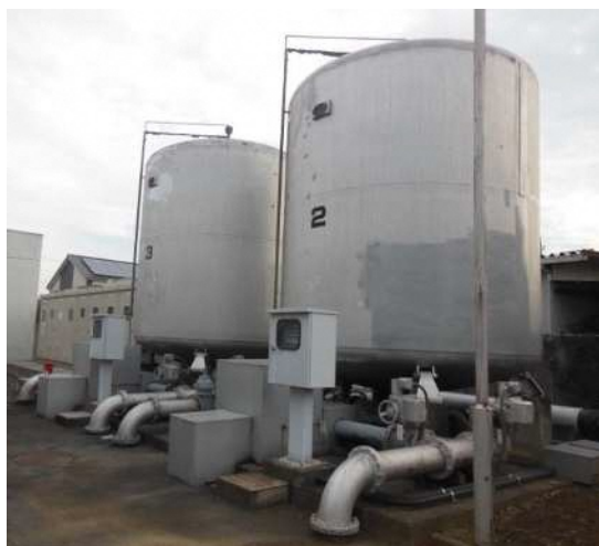
箕田浄水場 急速ろ過機 No.2, No.3
