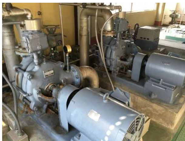
川里浄水場 配水ポンプ
