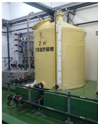
吹上第二浄水場 次亜注入設備
