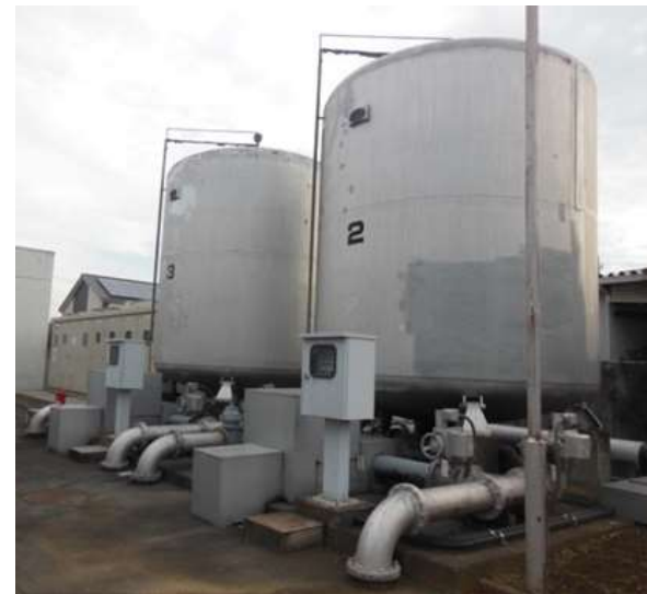
箕田浄水場 急速ろ過機No.2, No.3
