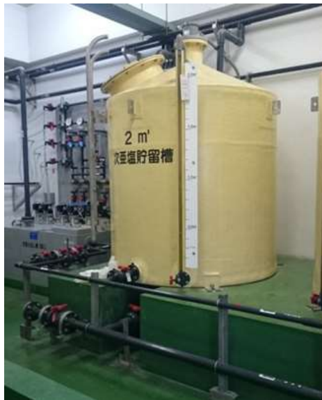
吹上第二浄水場 次亜注入設備
