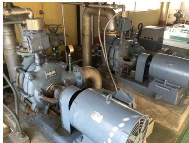
川里浄水場 配水ポンプ 【管路】
