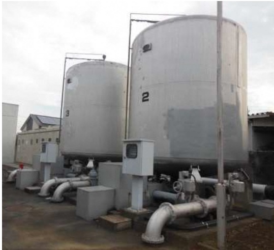
箕田浄水場 急速ろ過機 No.2, No.3
