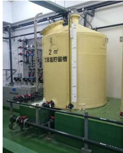
吹上第二浄水場 次亜注入設備
