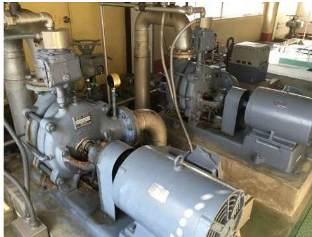
川里浄水場 配水ポンプ
