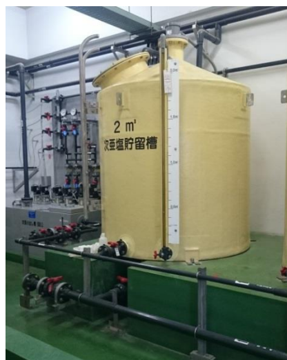
吹上第二浄水場 次亜注入設備
