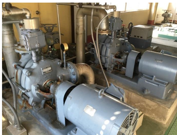
川里浄水場 配水ポンプ
