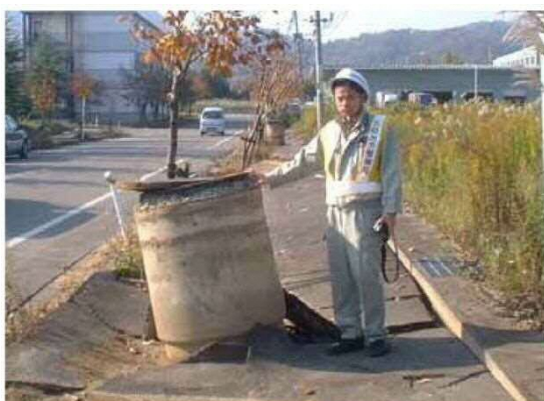
液状化によるマンホール突出 (下水道地震対策技術検討委員会報告書)
