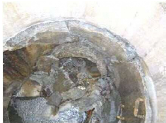
マンホールと管きょの接合部破損 (下水道地震・津波対策技術検討委員会報告書)
