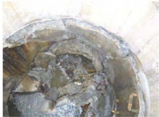
マンホールと管きょの接合部破損 (下水道地震・津波対策技術検討委員会報告書)
