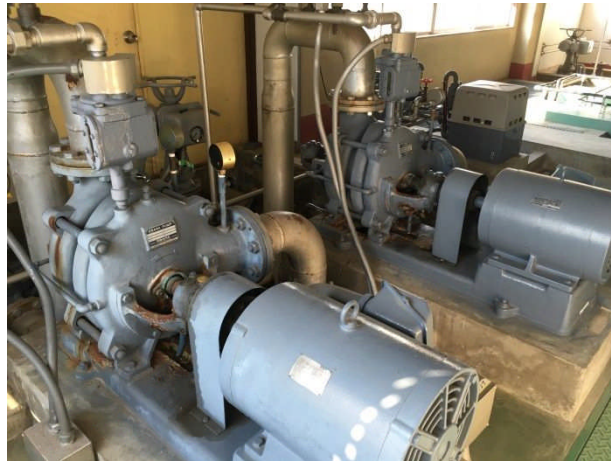
川里浄水場 配水ポンプ
