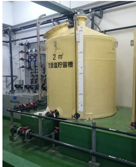
吹上第二浄水場 次亜注入設備
