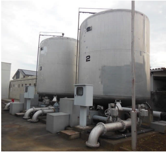
箕田浄水場 急速ろ過機 No.2, No.3
