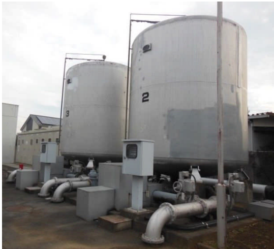
箕田浄水場 急速ろ過機 No.2, No.3
