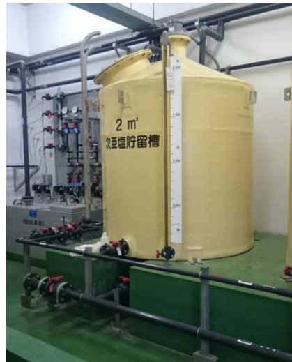
吹上第二浄水場 次亜注入設備
