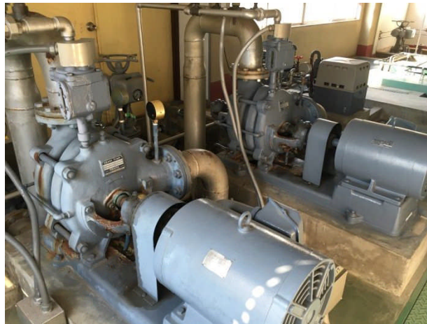
川里浄水場 配水ポンプ
