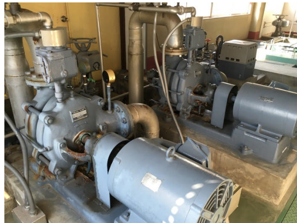
川里浄水場 配水ポンプ
