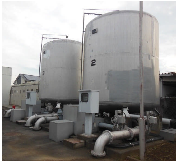
箕田浄水場 急速ろ過機 No.2, No.3
