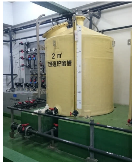
吹上第二浄水場 次亜注入設備
