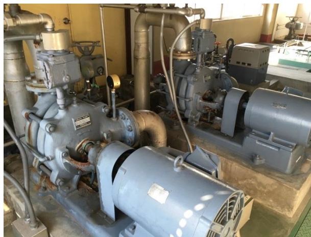
川里浄水場 配水ポンプ
