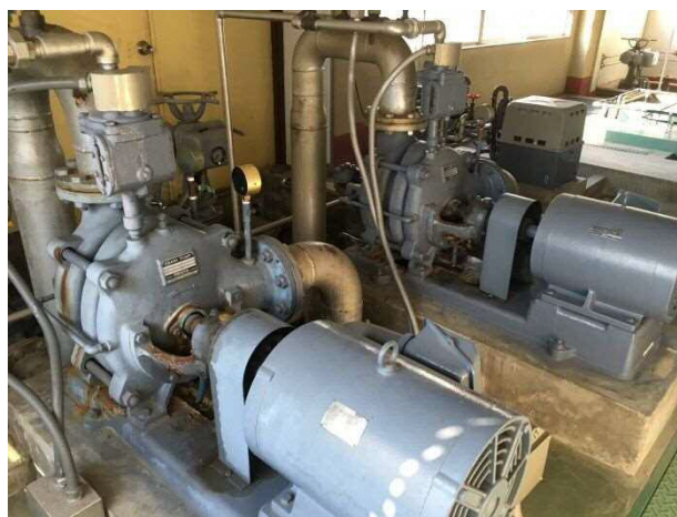
川里浄水場 配水ポンプ
