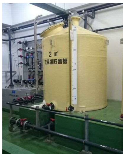
吹上第二浄水場 次亜注入設備
