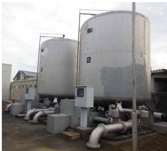
箕田浄水場 急速ろ過機 No.2, No.3
