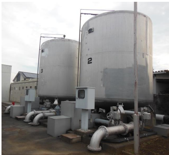
箕田浄水場 急速ろ過機 No.2, No.3
