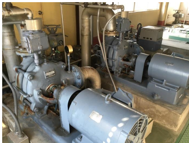
川里浄水場 配水ポンプ
