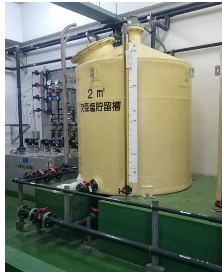
吹上第二浄水場 次亜注入設備
